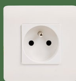
Jednofázová zásuvka 2,3 kW
